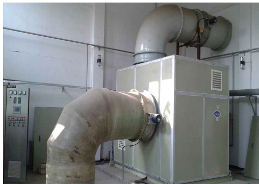
图 3-6 污泥处理区除臭设施
