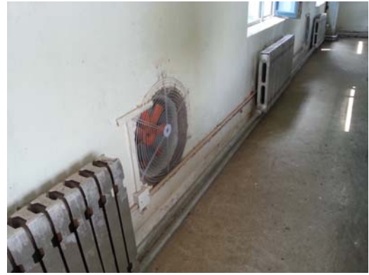
图 2 现状格栅间排风机
