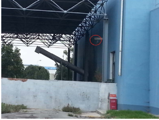
图 9 现状污泥脱水间废气排放口
