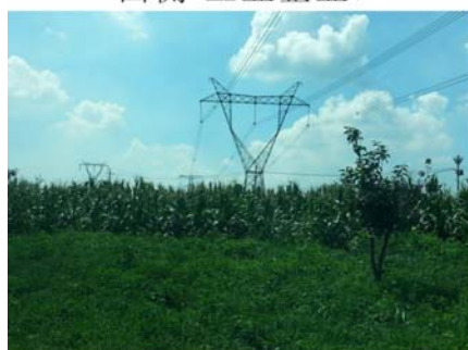
穿越厂区高压走廊
