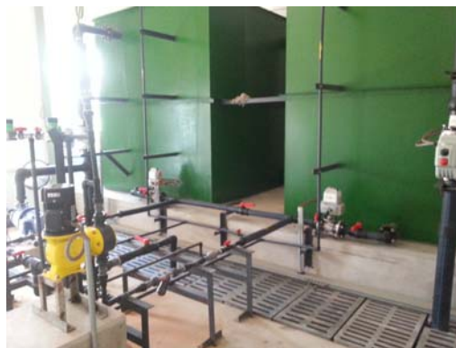
图 13 现状加氯消毒设备间
