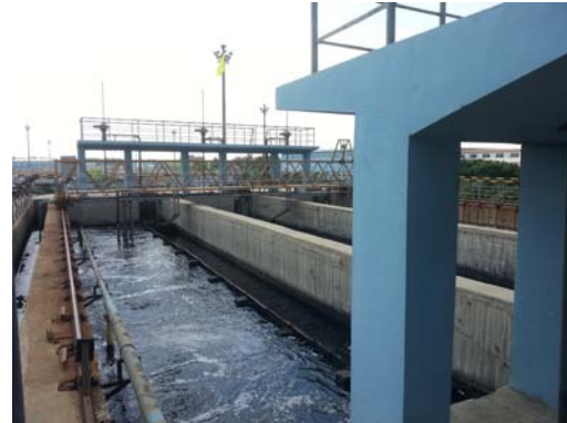
图 6 现状曝气沉砂池
